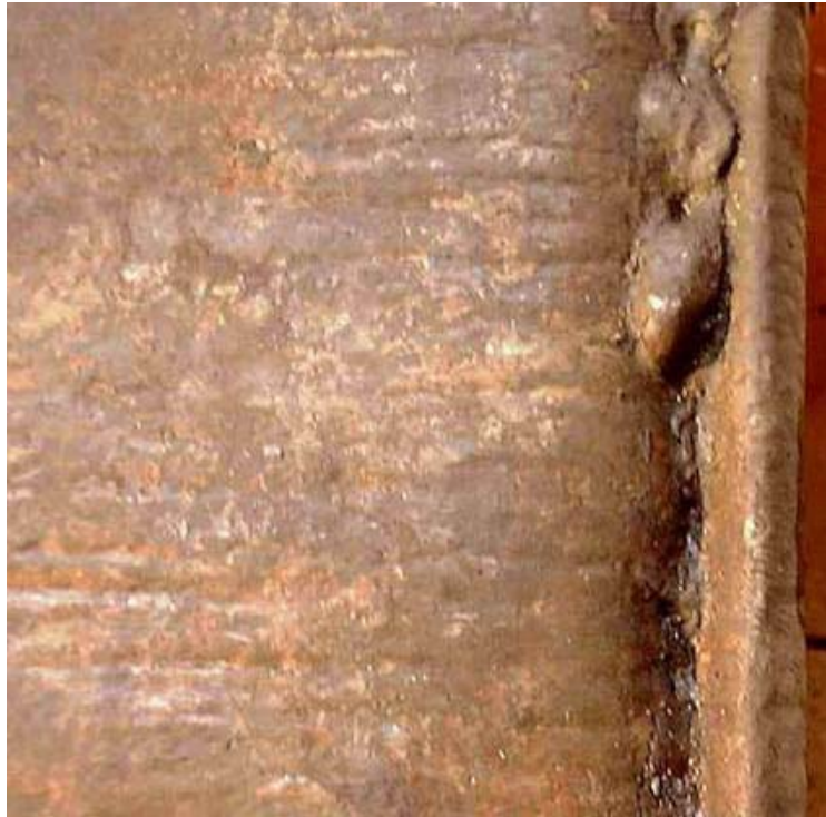
Figura 4. Aspecto de la esquina de un planchón, momentos antes de producirse la perforación.
